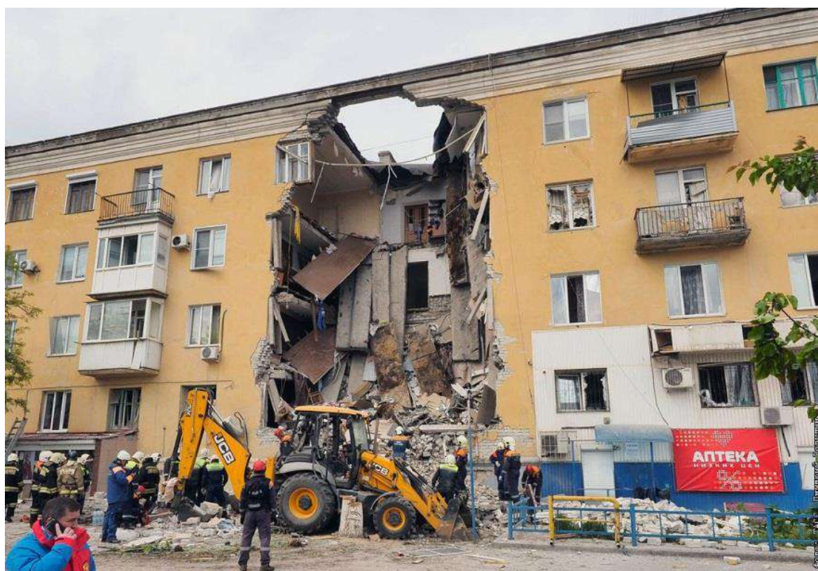
Рисунок 3 – Обрушение жилых помещений
